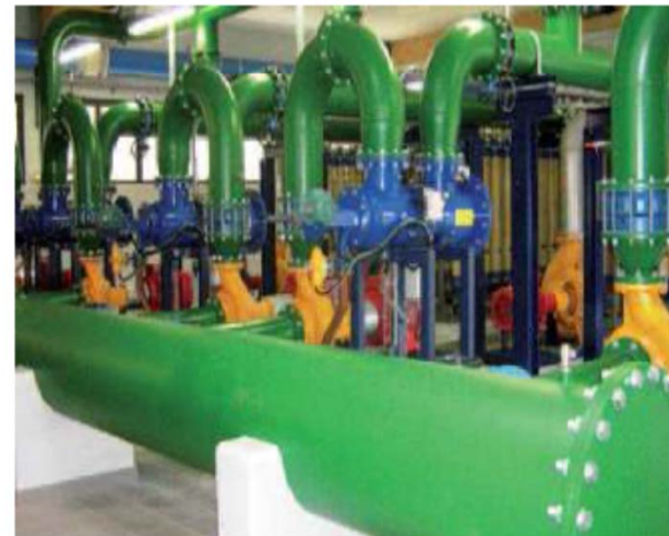
Pompes à axe horizontal installées en fosse sèche
