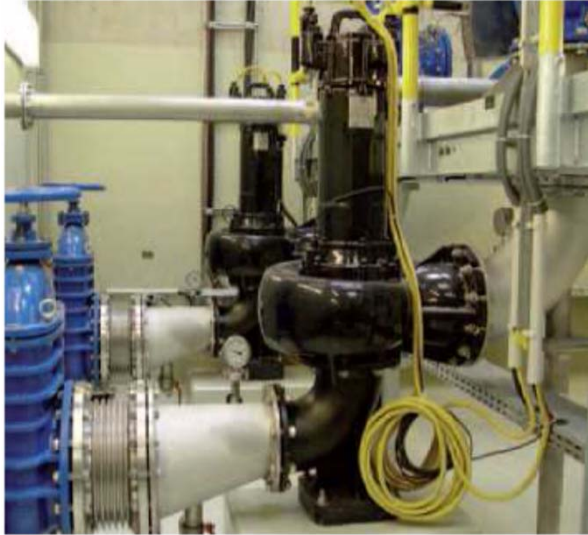
Pompes à axe vertical installées en fosse sèche
