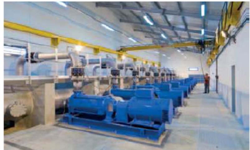
Station de pompage pour l'irrigation équipée de 9 groupes multicellulaires horizontaux, puissance unitaire 400 kW
