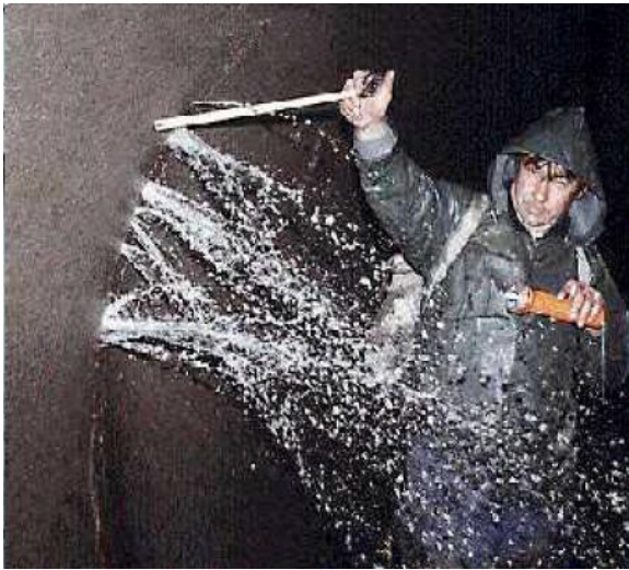
Figure II.21. Présence des fuites au niveau de la galerie.
