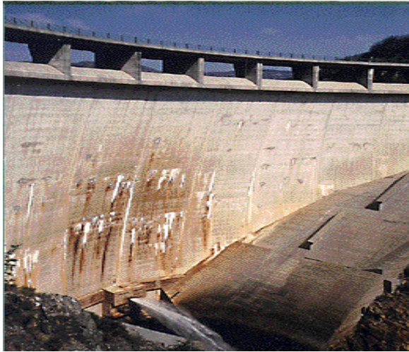
Figure II.18. Dépôt de calcite au niveau du parement du barrage.
