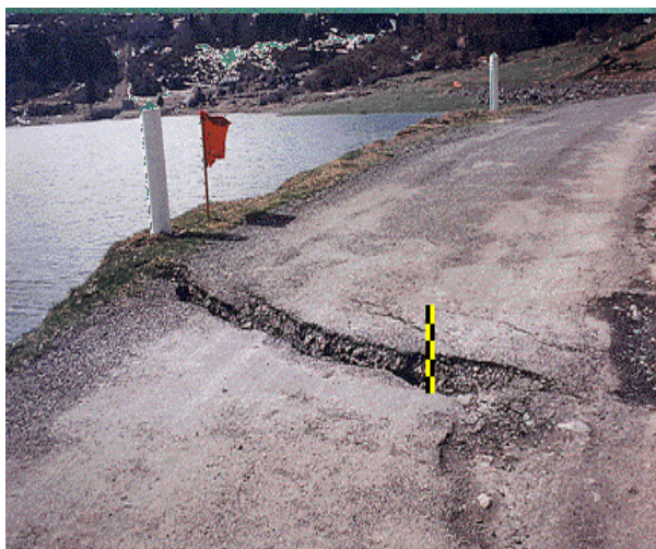
Figure II.13. Fissures au niveau de la crête.
