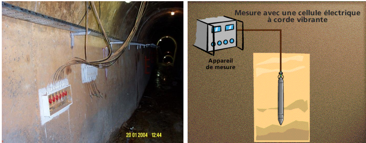
Figure III.36. Mesure de pression interstitielle par capteur électrique dans la galerie de visite du barrage Sidi Abdelli, Wilaya de Tlemcen [70].
