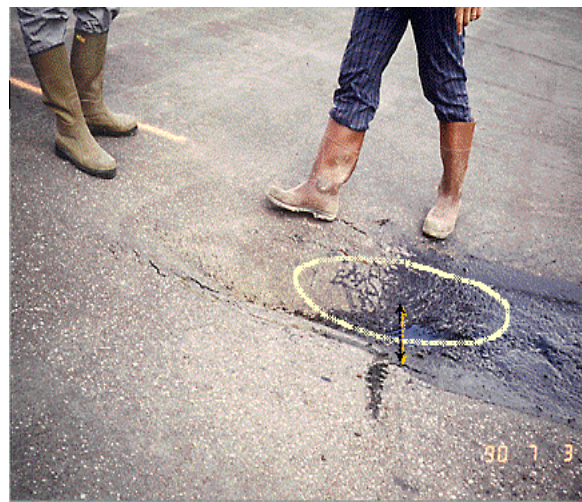
Figure II.14. Déformation du masque amont d'un barrage en terre.
