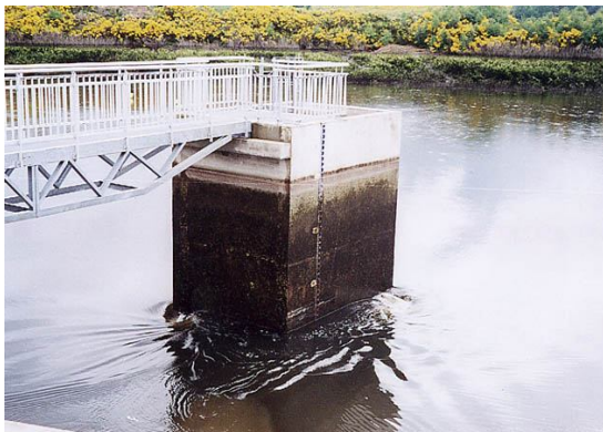
Figure II.7. Signes d'érosion régressive autour de l'ouvrage de prise.
