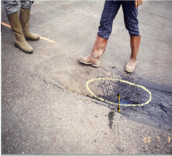
Figure III.3. Tassement au niveau de la crête du barrage.
