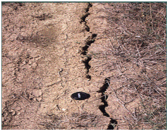
Figure II.11. Fissures au niveau de la crête.
