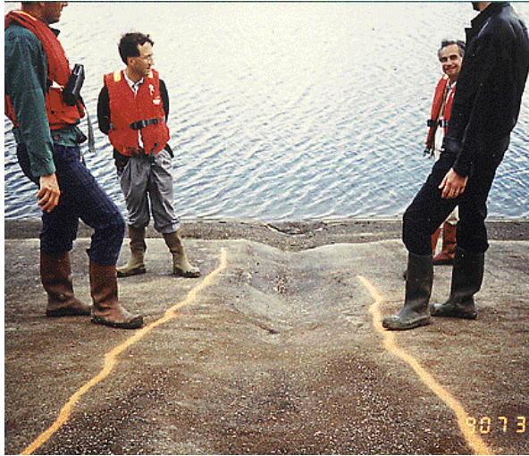
Figure II.15. Dégradation du masque amont.
