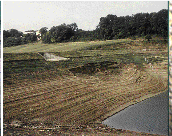
Figure II.4. Glissement du talus amont d'un barrage enterre.
