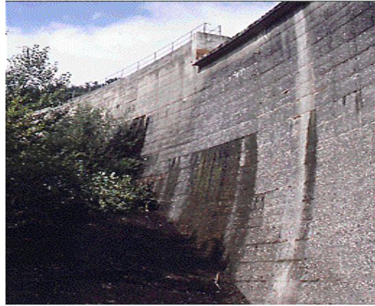
Figure II.2. Apparition des zones humides sur le parement aval d'un barrage en maçonnerie.
