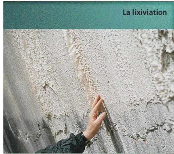
Figure II.19. Lixiviation du béton au niveau du parement du barrage.
