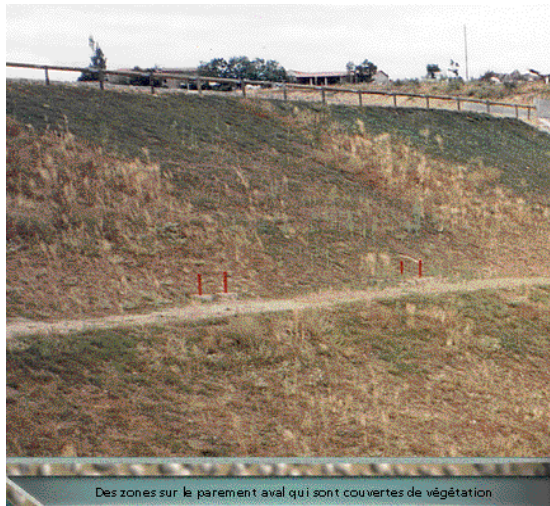
Figure II.5. Présence de végétation sur le talus aval d'un barrage en terre.
