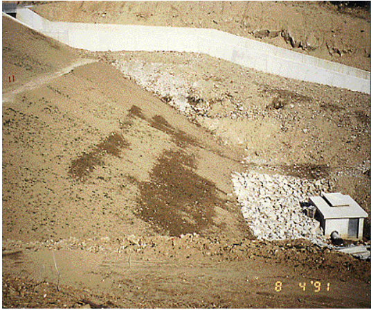
Figure II.1. Apparition des zones humides sur le talus aval d'un barrage en terre.
