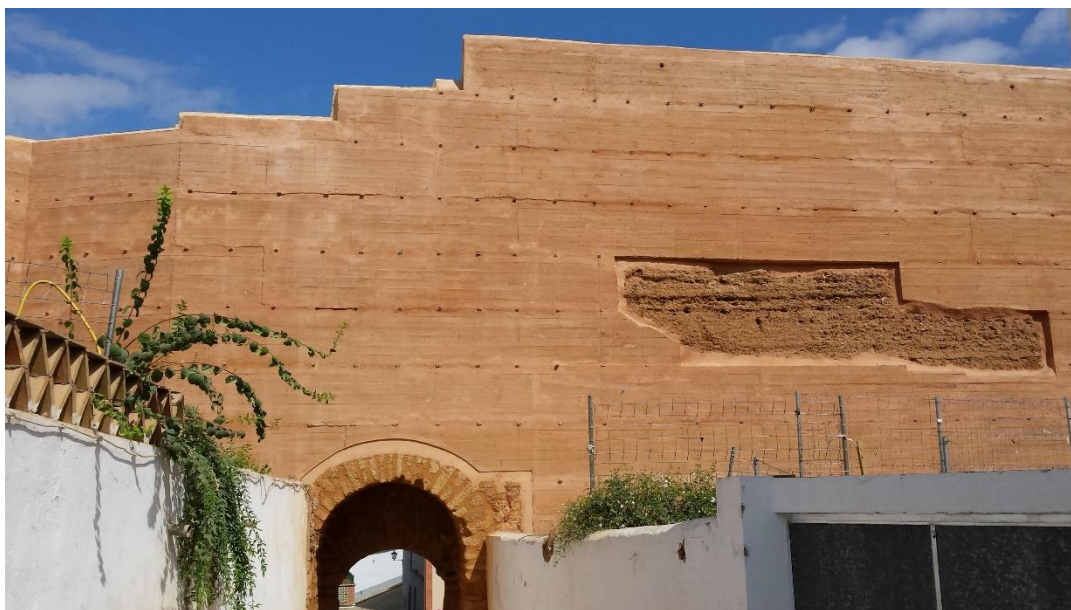
Figure 30. Différence de texture pour le nouvel enduit. Source Camilla MILETO
