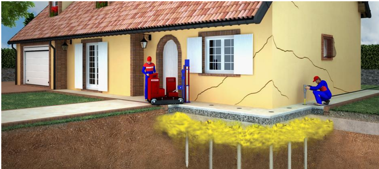
Figure 17. Stabilisation du sol suite à un tassement différentiel
