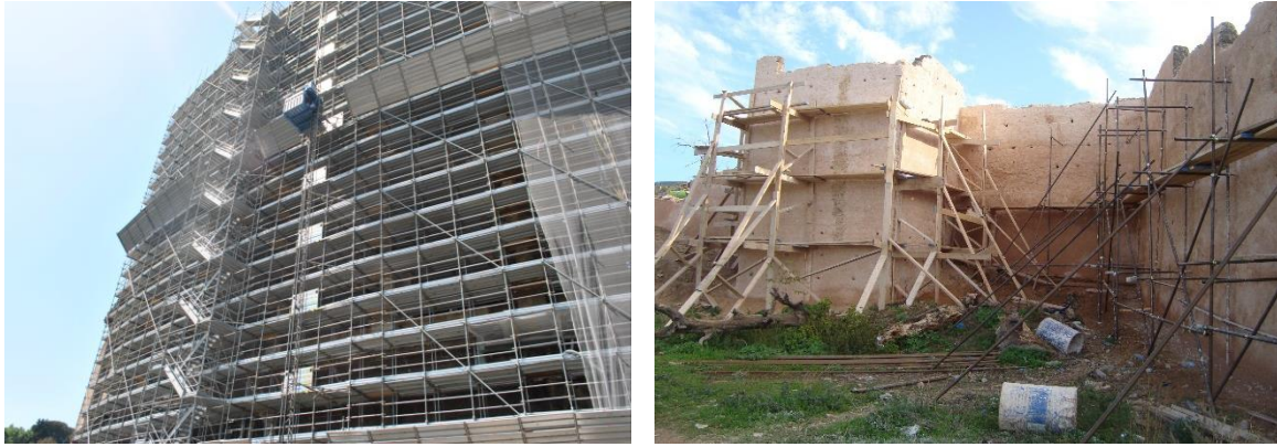
Figure 13. Différents types d'échafaudage (colisée de Rome à gauche, et Bâb Al Qarmadin à droite). Source Selka Chihab
