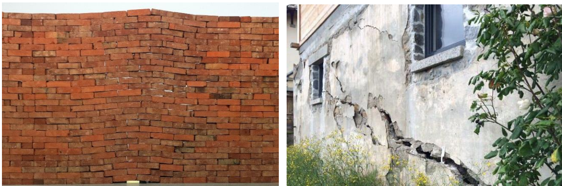
Figure 5. Lésions mécaniques (déplacement horizontal à droite et tassement différentiel à gauche)
