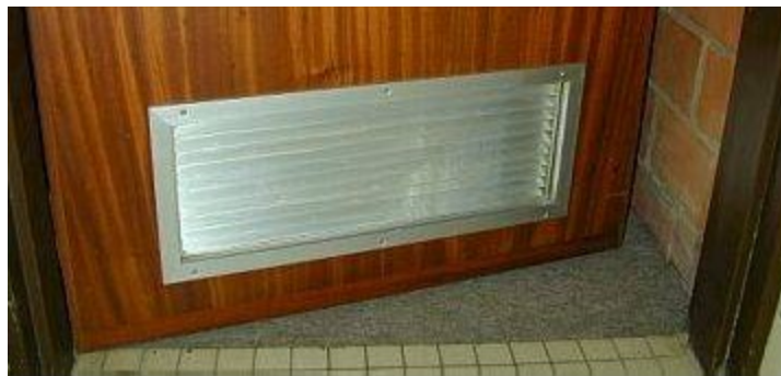
Figure 45. Transfert de ventilation par grille
