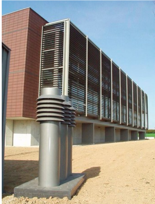
Figure 50. La vue de la prise d'air (source : Energie +)
