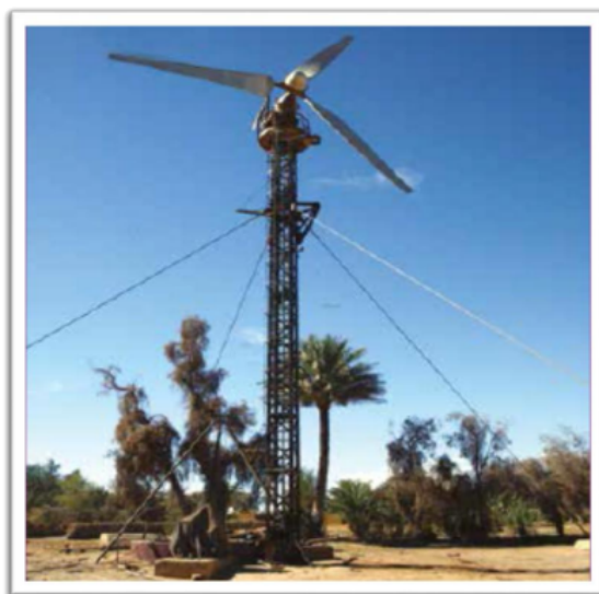
Figure II.7: Éolienne de 100 kW
