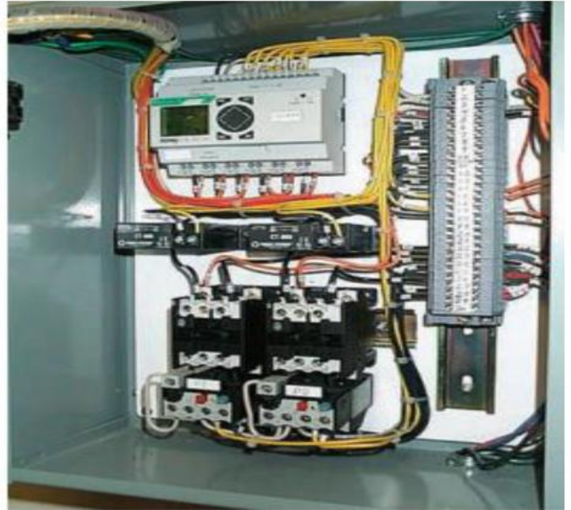
Armoire à API
