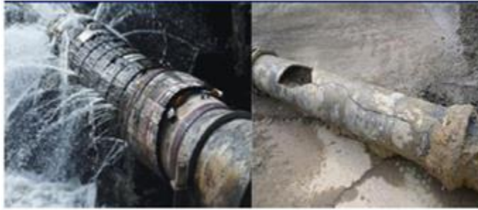
Rupture de conduites
