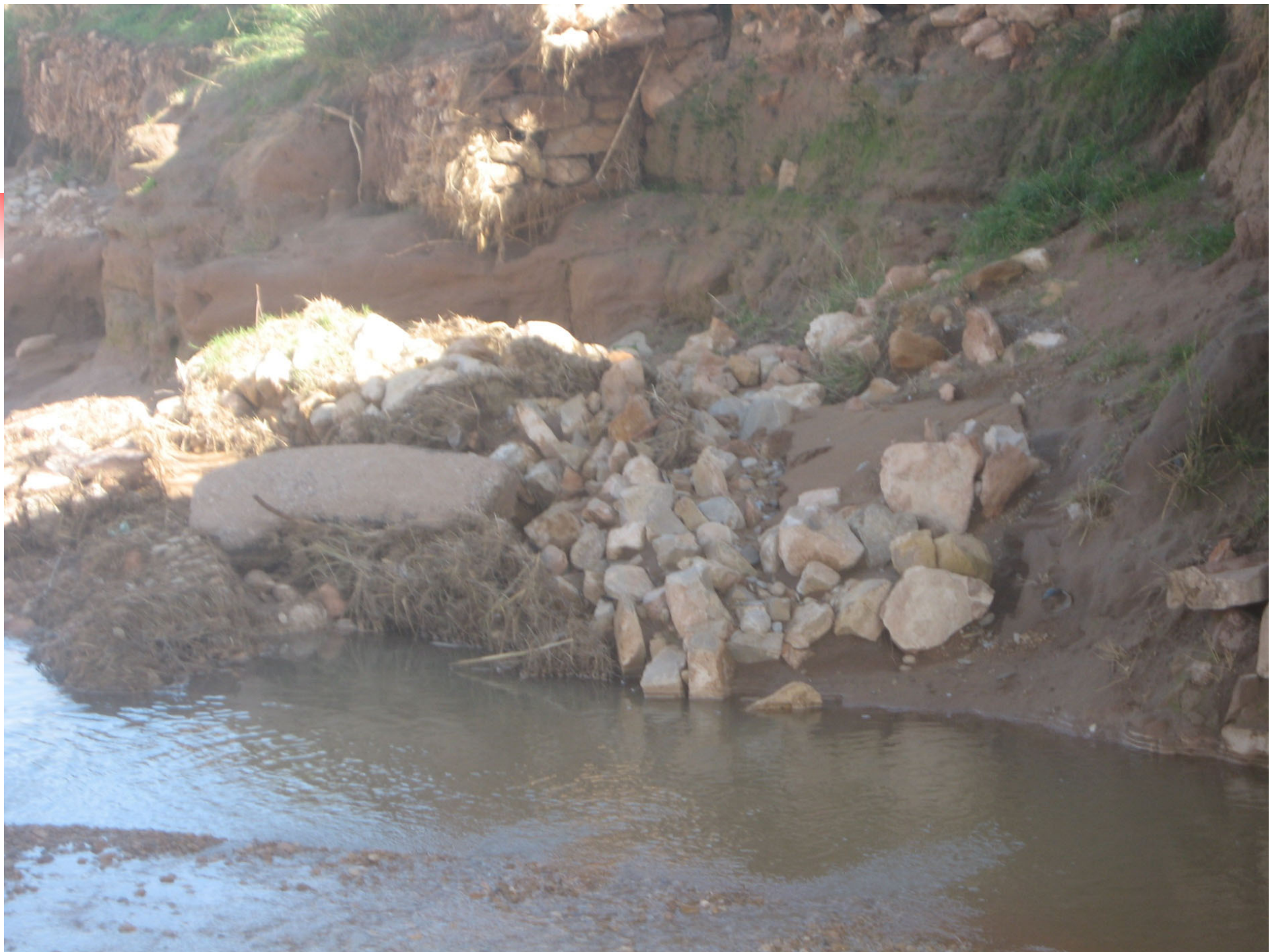
Déstabilisation de la berge du cours d'eau, effondrement des gabions
