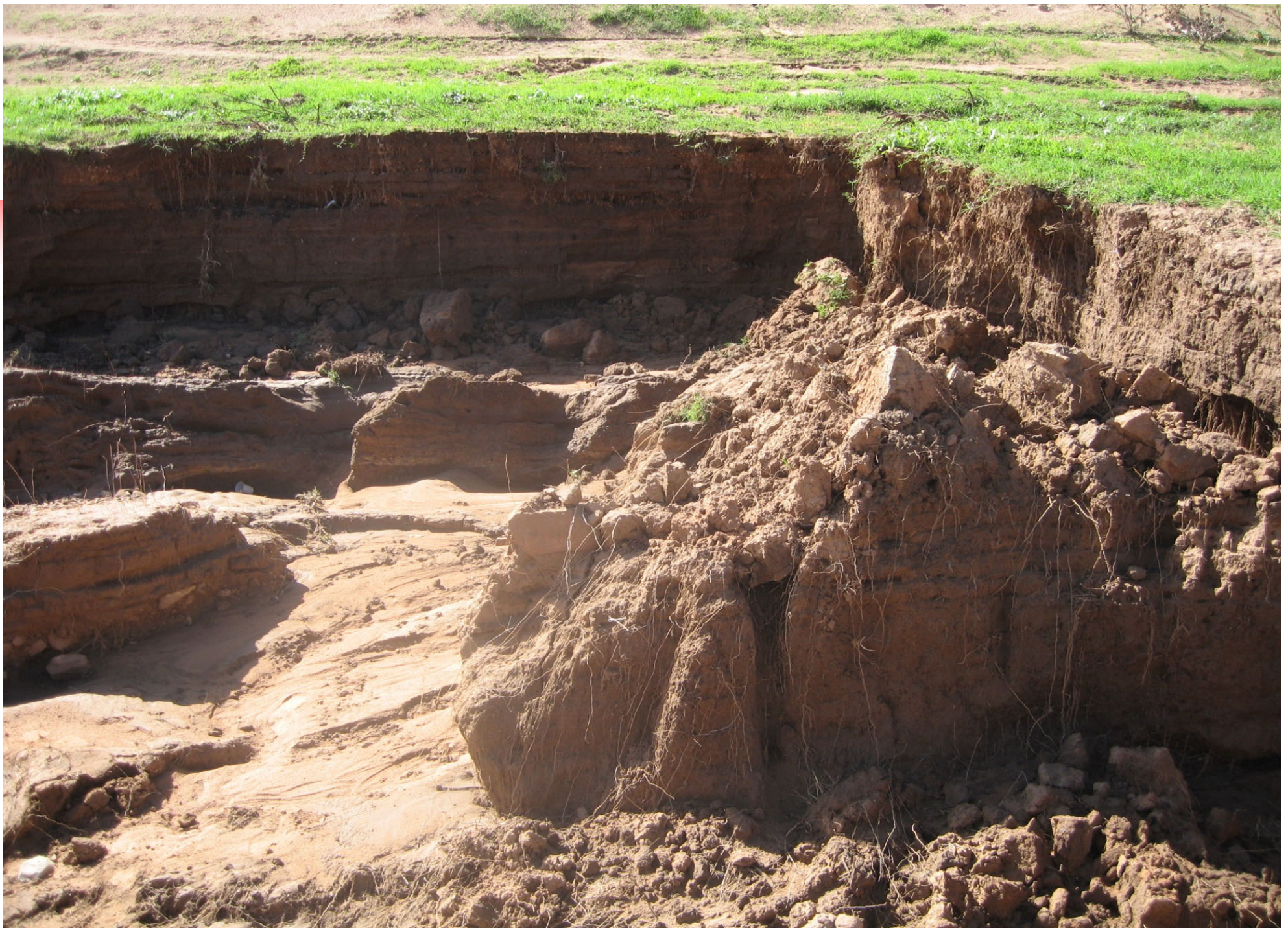
Erosion au niveau du lit majeur du cours d'eau au cours d'une seule crue
