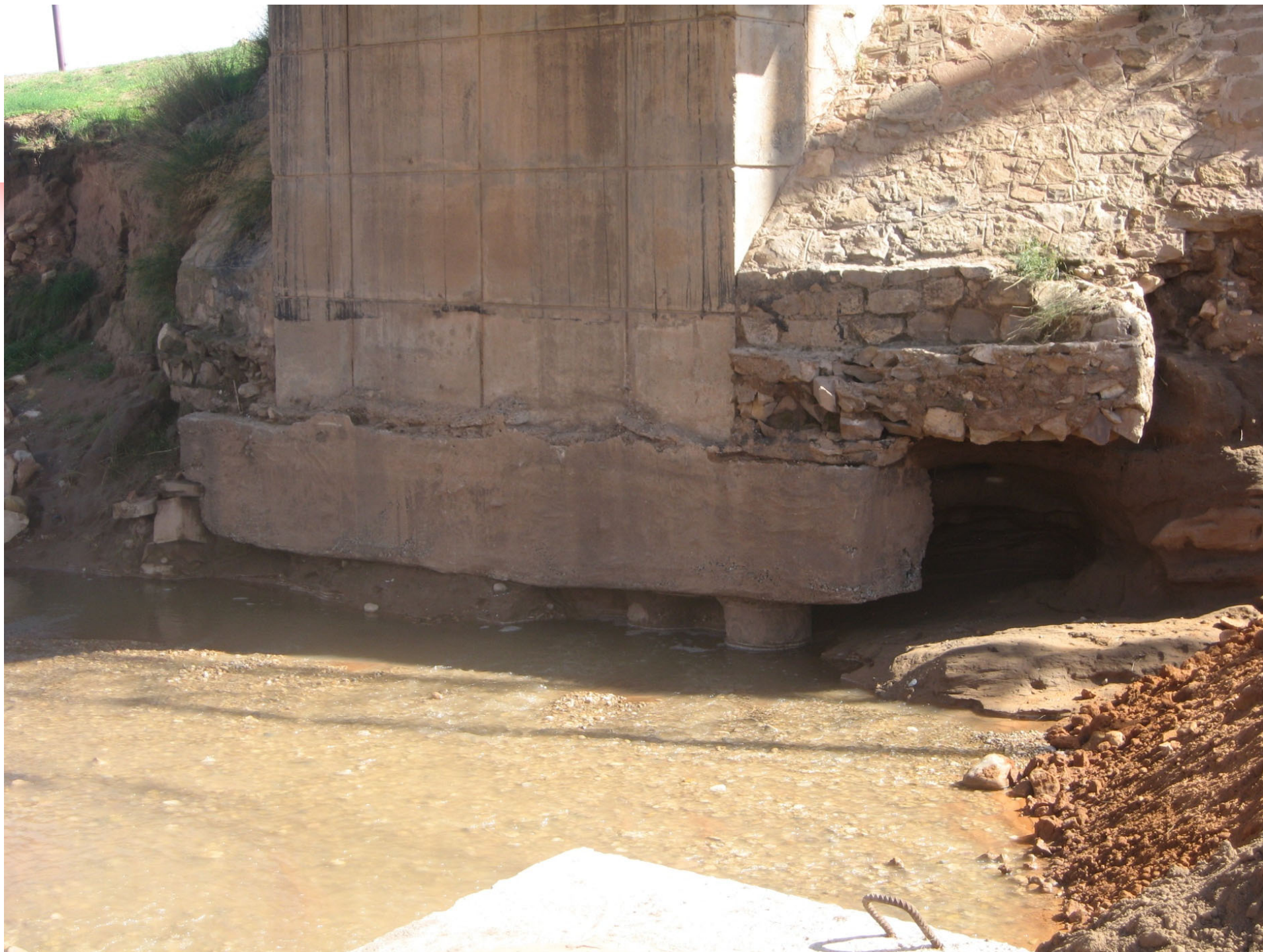
Affouillement au niveau de la culée d'un pont enjambant le cours d'eau
