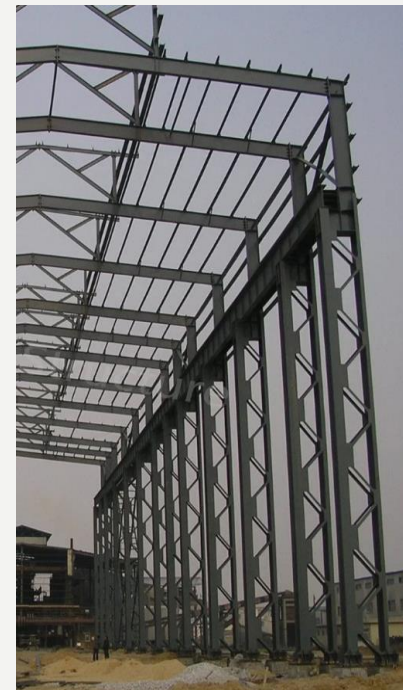
Poteau en treillis
